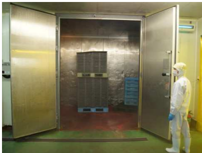
⑪冷蔵保管設備
