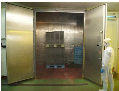
⑪冷蔵保管設備
